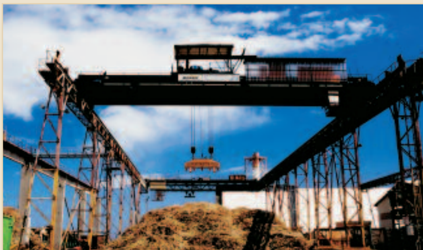
Le nouveau pont roulant de 16 tonnes de l'usine du Gol compense la fermeture de la plate-forme de Pierrefonds devenue obsolète.
